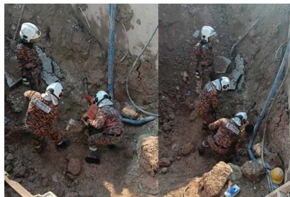
Anggota Bomba dan Penyelamat sedang mengeluarkan mangsa tertimbus akibat tanah runtuh, pada Selasa.
