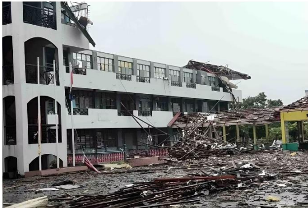
Sekolah Kebangsaan (SK) Sijangkang Jaya mengalami kerosakan akibat dilanda ribut | Sinar Harian
